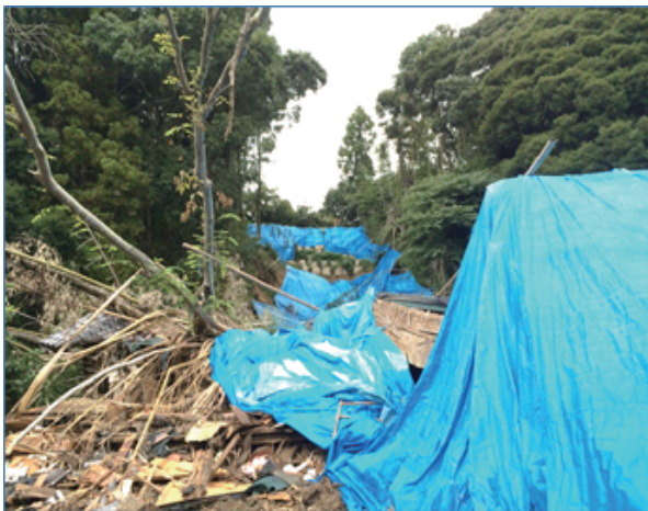
崩壊した県道脇の法面 (9/18 酒々井町下岩橋)
