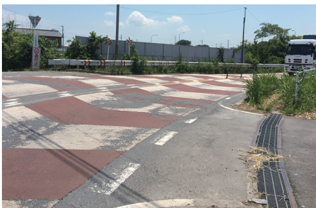
路面損傷が激しい国道356号（印旛郡栄町）
