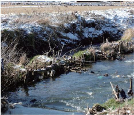
流水量の増加により洗掘が進む高崎川（酒々井町）
