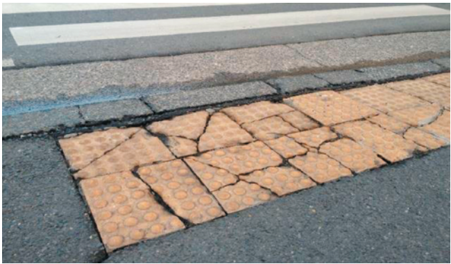
障害者が危険箇所を察知できず、事故につながる危険が大きい。(JR津田沼駅付近)
