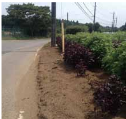
町道にはみ出す土砂（酒々井）
