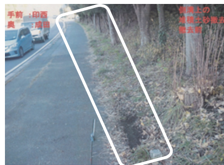
酒直台セブンイレブン前から成田方面への上り坂 (堆積土砂により側溝が機能していませんでした)
