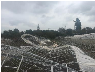
被災した農業用ハウス
