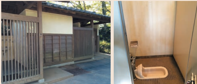
老朽化が進む房総のむらの公衆トイレ（印旛郡栄町）
